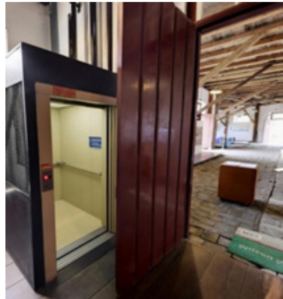
Figura 6. Elevador Figura 7. Teclado do Elevador
